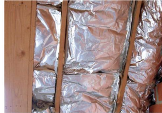
Verkeerd geplaatste spijkerflensdekens. Foto: Rockwool
