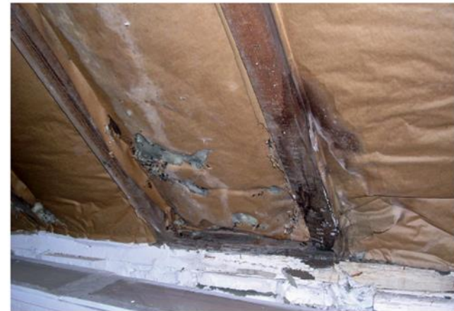
Verkeerd aangebrachte of isolatie in slechte staat verwijderen.
